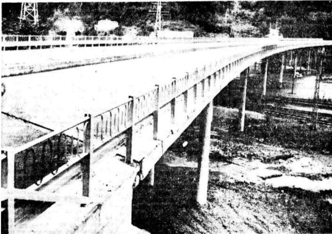
Den nye broen som fører Drammensveien utenom Asker sentrum er en del av veistrekingen som ble åpnet idag.
